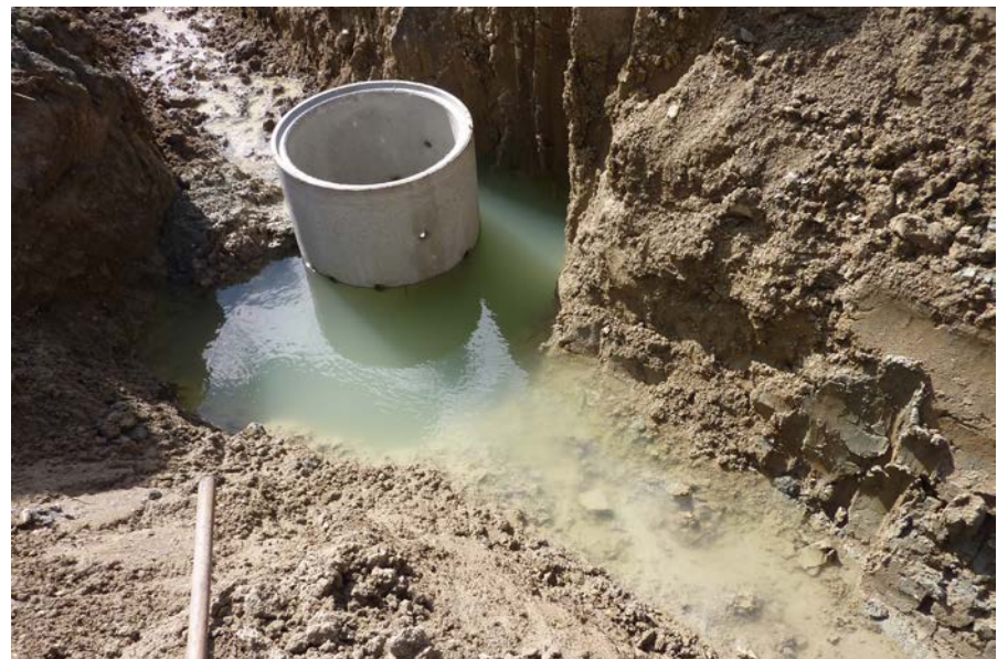
captage de source
